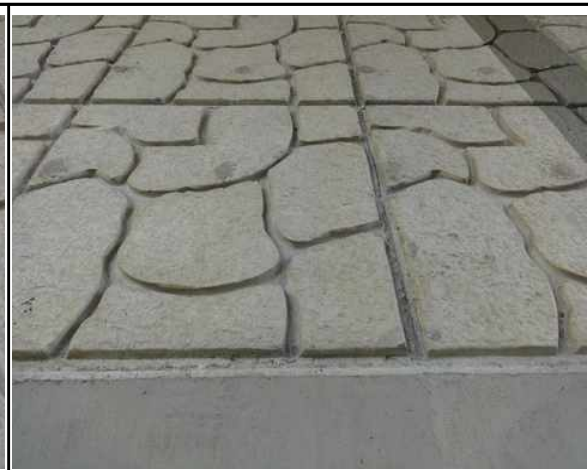
A2 균열 CW=0.1mm
